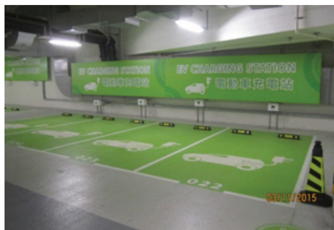
电动车充电站
