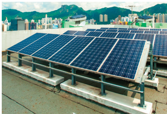
太阳能光伏板
