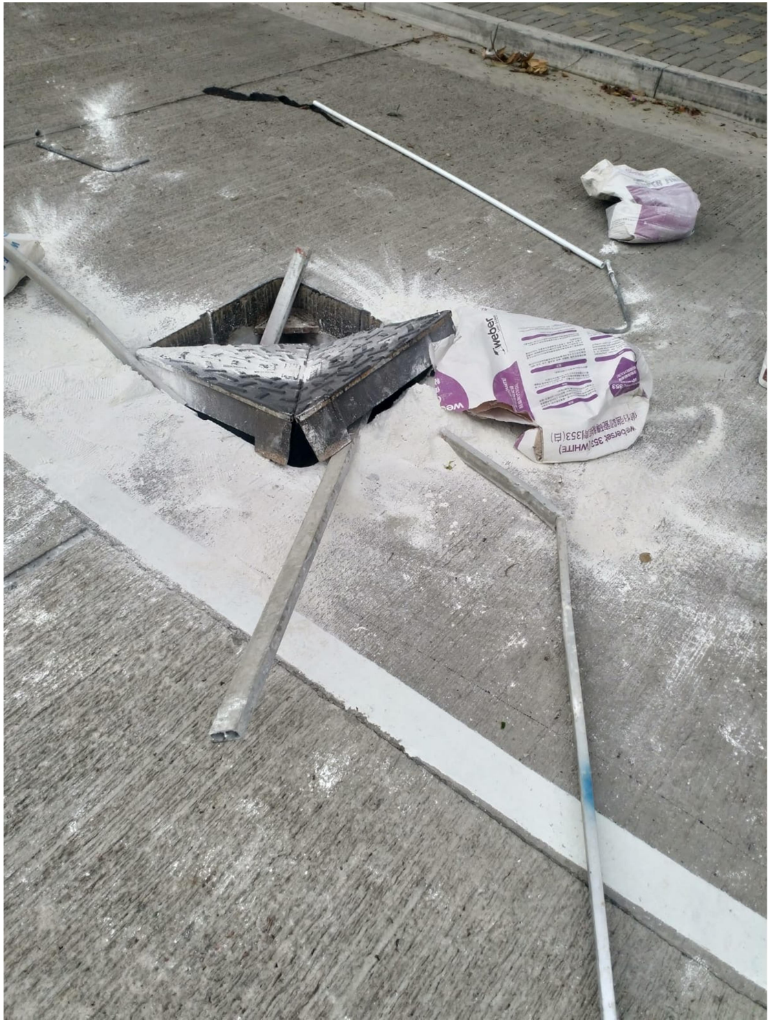
圖五：消防通道上污水沙井被英坭淤塞及渠蓋被破壞
