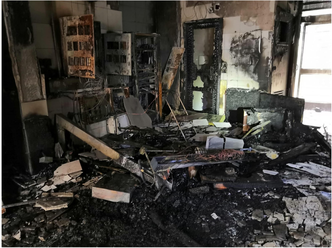
圖三：第二座大堂的保安櫃台及消防控制箱及警報系統被破壞的情況
