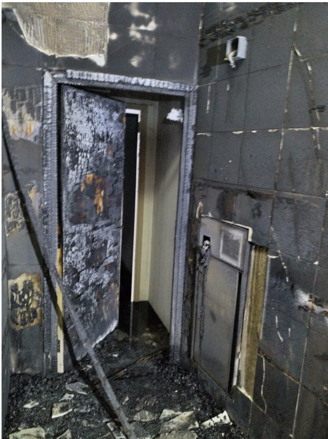
圖六：第2座地下大堂走火樓梯的防火門被嚴重燒毀
