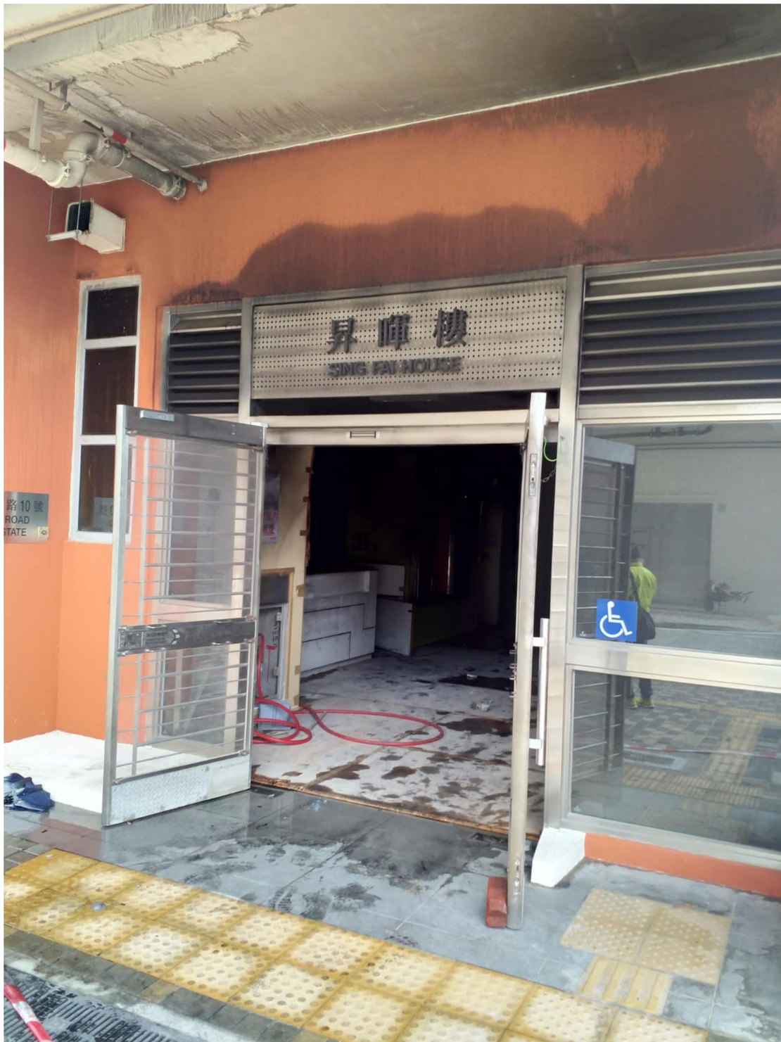
圖一：第一座入口被破壞的情況
