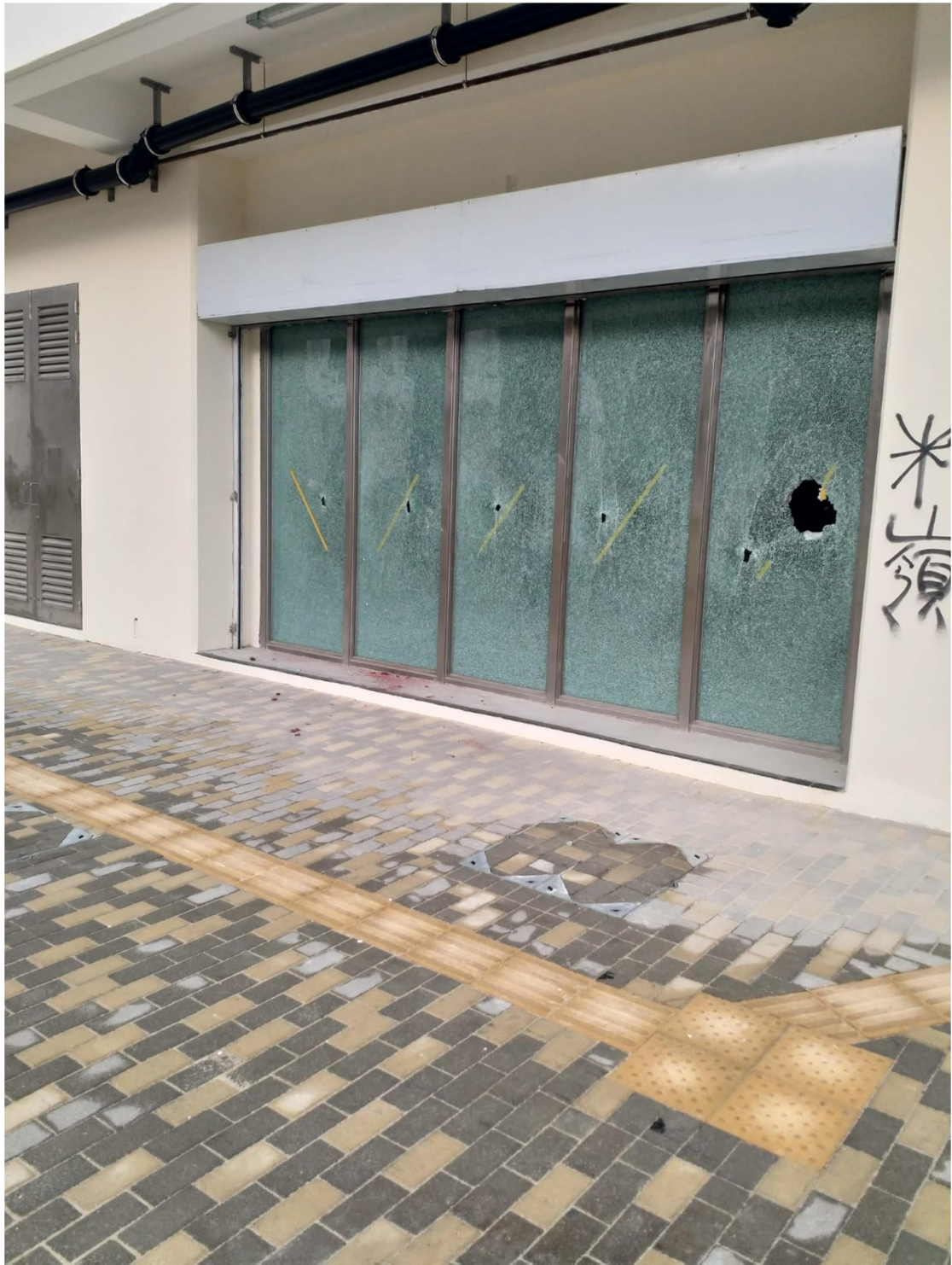
圖四：第一座地下的商鋪玻璃被破壞
