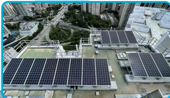
太阳能光伏电板
