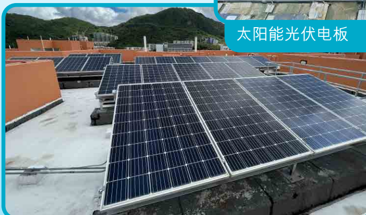
太阳能光伏电板
