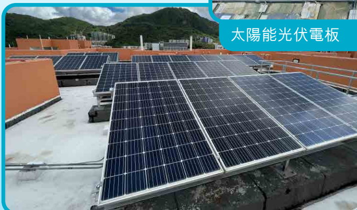
太陽能光伏電板
