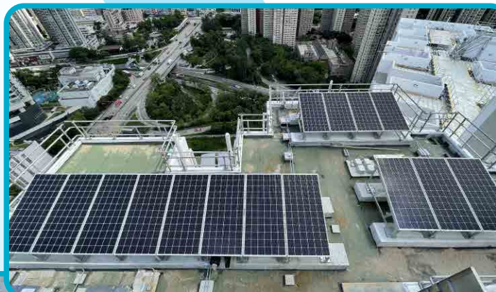
太陽能光伏電板
