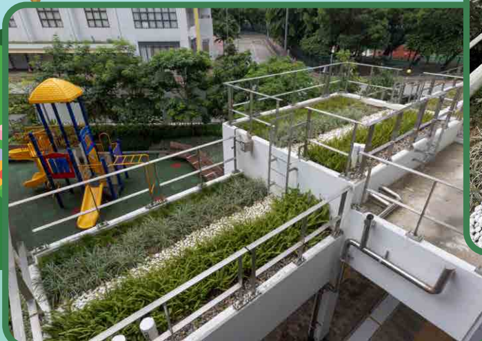
东汇邨汇智楼的屋顶绿化应用了零灌溉系统
