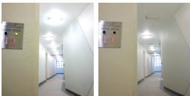
■ 两级光度照明控制系统 — (左)全照明，(右)部分照明。
