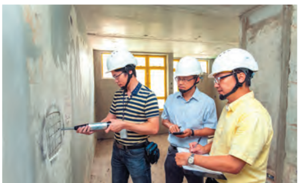
独立审查组辖下的地盘监察小组正在进行混凝土强度测试。
