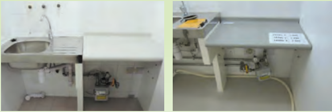
灶台可调校不同高度，切合住户所需。 下方照片显示入住后厨房的摆设。
