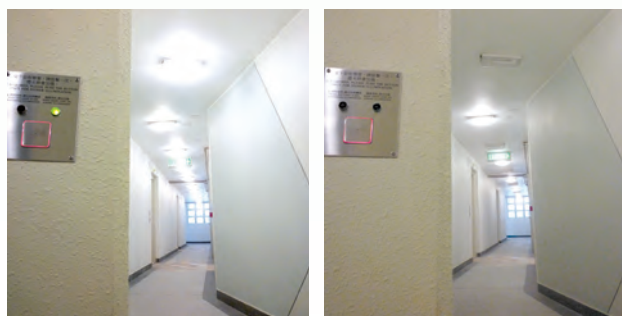
■ 兩級光度照明控制系統 — (左)全照明，(右)部分照明。
