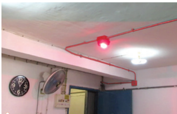
公屋單位內的「火警視像警報系統」閃動 Flashing of a visual fire alarm system inside a PRH flat
