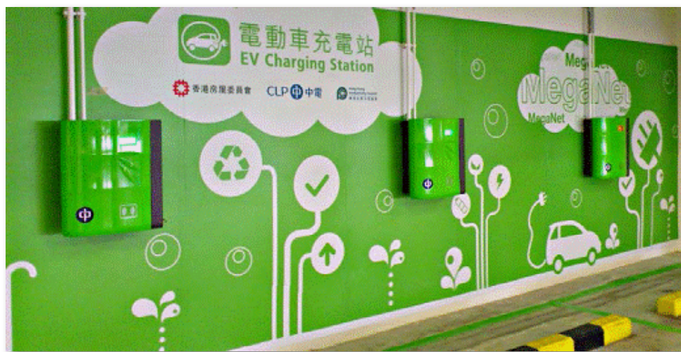
彩德商场停车场的电动车充电设施
