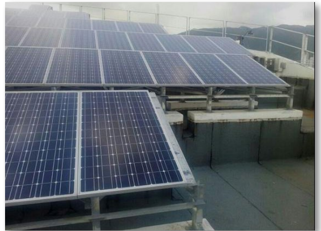
启德第一甲区的太阳能光伏板
