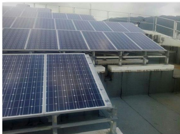
啟德第一甲區的的太陽能光伏板
