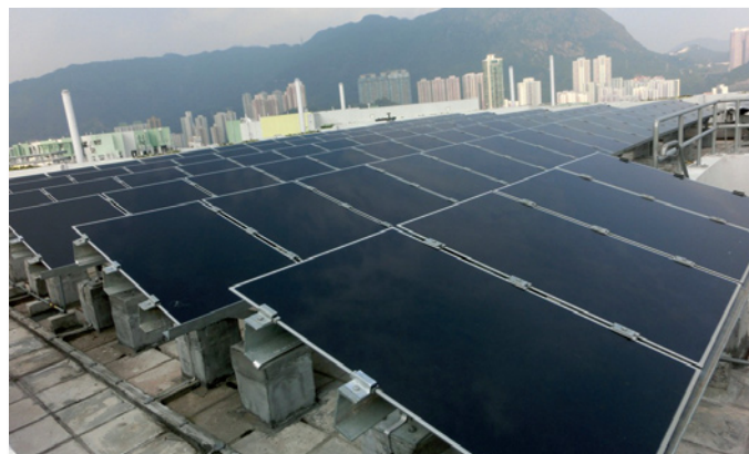
启德第一乙区的太阳能光伏板
