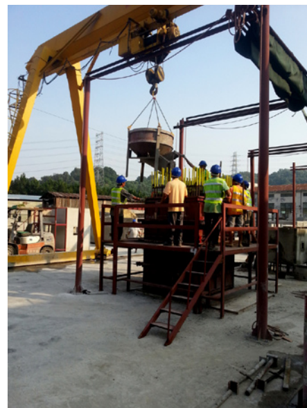
水泉澳一期的预制沙井
