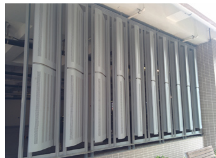
长沙湾邨的生物过滤器
