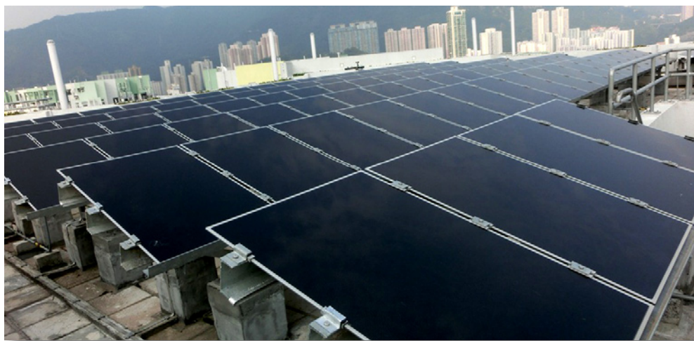
启德第一乙区的太阳能光伏板
