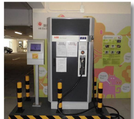
漁灣邨停車場的電動車充電設施
