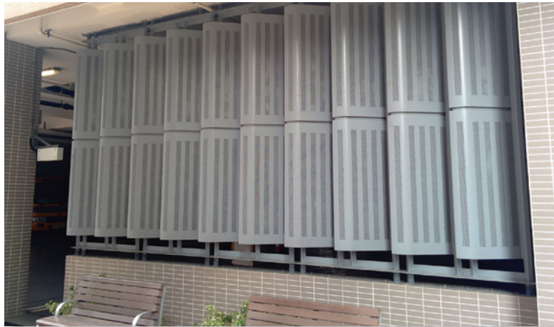
位于长沙湾邨的菇废生物过滤器
