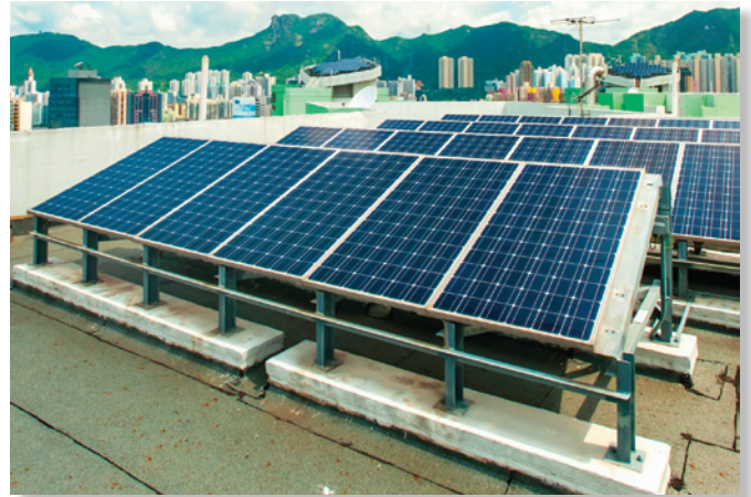
太陽能光伏板
