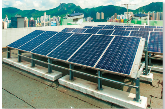
太陽能光伏板
