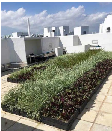
▲ 住宅大厦天台的雨水收集系统
