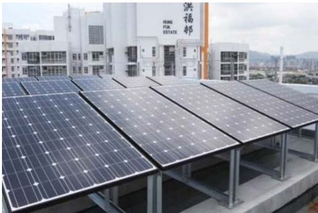
▲ 太陽能光伏板
