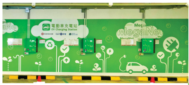
▲ 电动车辆充电设施
