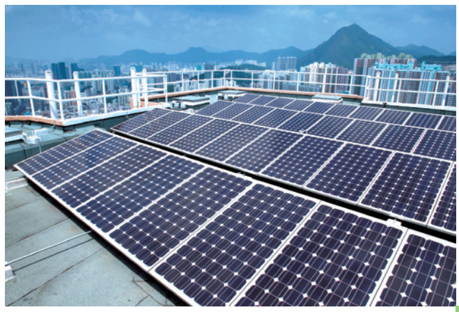
▲ 太阳能光伏板
