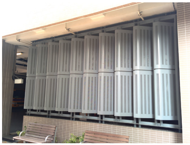
▲ 长沙湾邨的菇废生物过滤系统
