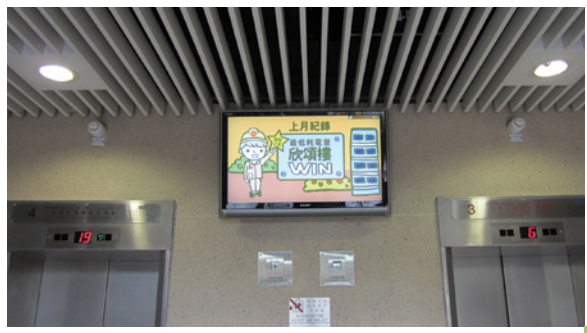
▲ 設置在大堂配備顯示屏的智能計量儀監察系統
