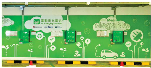
▲ 電動車輛充電設施
