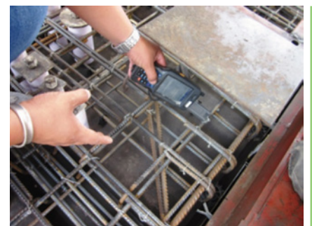
◆ 無線射頻識別技術用於追查建築組件運送過程以及建築地盤廢料處置情況
