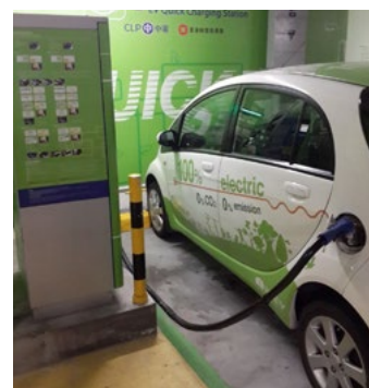
电动车辆充电设施
