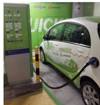
電動車輛充電設施
