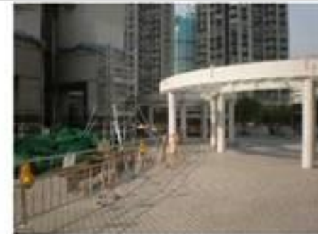
照片 1：發現工人在動工前未將材料及物品妥善收放於安全警告告示內，大廈天面及天台圍欄中發現安全警告告示內，大廈天面天台圍欄中，發現材料堆放工人。
