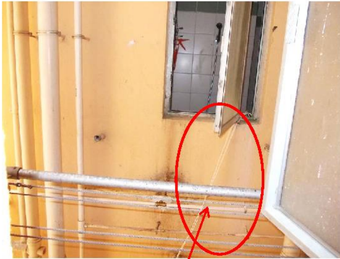
事發後現場外牆窗邊仍掛 有晾衣架用的尼龍繩
