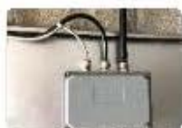
移動基站 -每條隧道內 安裝3~4個
