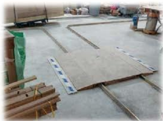
路面不平位之處理
