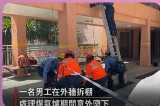
6/3/23 沙田美林邨棚架，工人失足墮平台受傷
