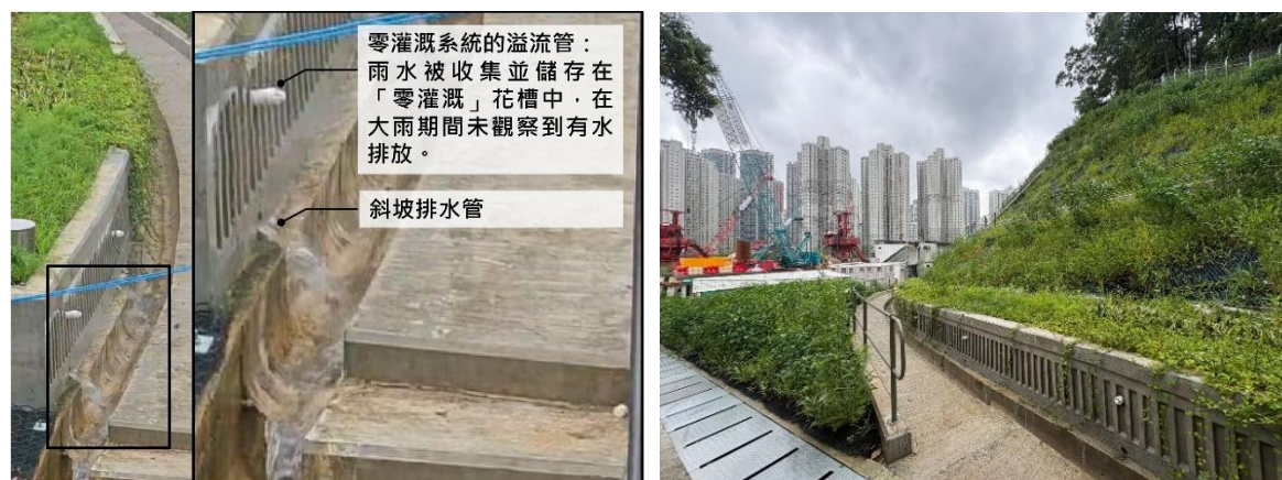
零灌溉系统在红色暴雨警告信号期间（左）和黑色暴雨警告信号后，仍然运作良好。
