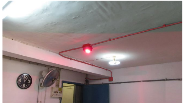
图为安装于听障居民单元内的火警视像警报系统，每当发生火警或其他紧急事故时，系统的发光灯便会亮起，警示居民。
