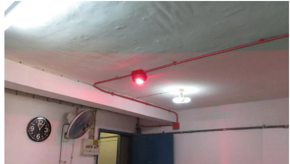
圖為安裝於聽障居民單位內的火警視像警報系統，每當發生火警或其他緊急事故時，系統的發光燈便會亮起，警示居民。
